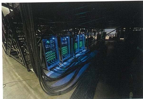
写真9 ステージ下の給電用コンセントラック
