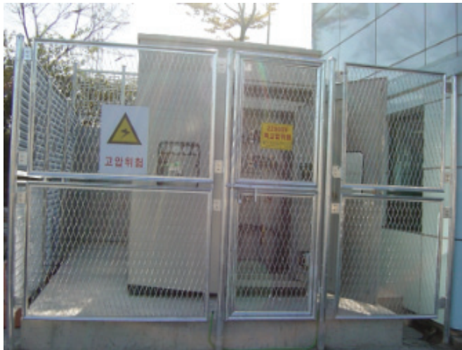
〈옥외 수전반에 설치된 방호 펜스 및 위험표식 예〉
