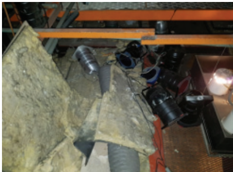
상부 그리드에 방치된 불필요 잔존물
