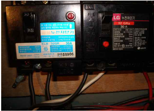
그림 159 배선용 차단기의 테스트버튼 미동작 (불량)
