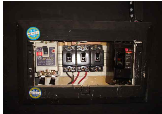
그림 166 접지선 부재로 인한 절연저항 측정 불가 (불량)
