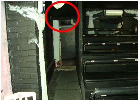
그림 39 출입문 상단 비상조명등 미설치 (불량)
