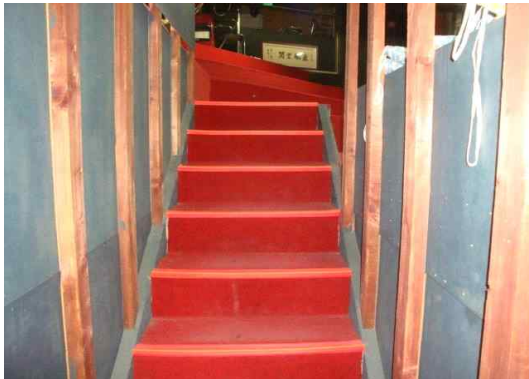
그림 51 공연장 내부 진입로 방염 안 됨 (불량)
