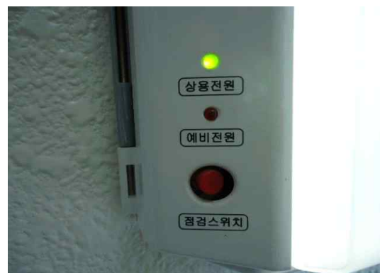
그림 36 피난구유도등 점검 스위치 및 전원 감시등
