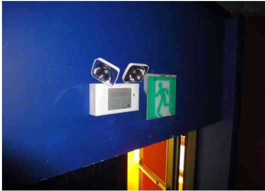
그림 37 극장 내 출입문 상단 비상조명등 설치상태 (양호)
