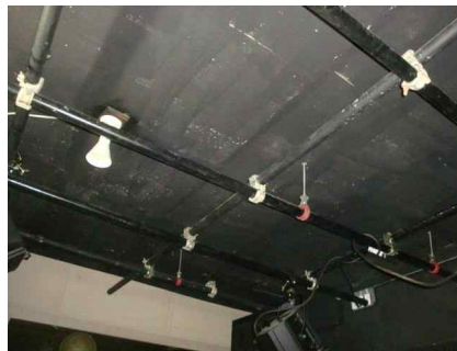
그림 121 무대 천장 누수, 균열 미발생 예
