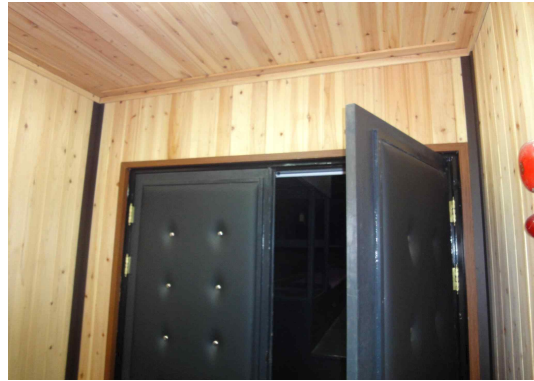
그림 38 극장 내 출입문 상단 비상조명등 미설치 (불량)
