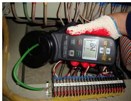
그림 80 배전반 내 접지저항 측정 예
