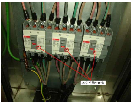
그림 60 배선용 차단기 외관 상태 예
