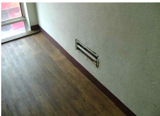
그림 136 계 유도등 파손 (불량)
