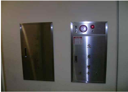
그림 142 소화전과 방수장치 설치상태 (예)
