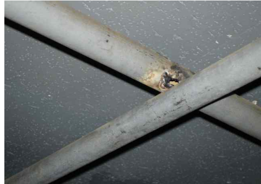
그림 193 장치봉 고정 용접부 용접부 파손 (불량)
